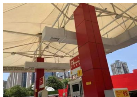
图3 加油站蒸发式冷气机实际工程安装图
